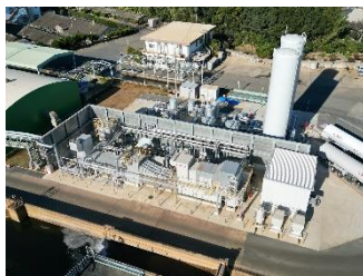
LNG サテライト設備 外観
