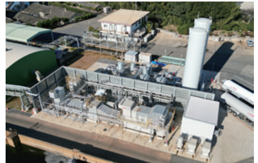
▲ 岡山工場 LNGサテライト設備 外観
